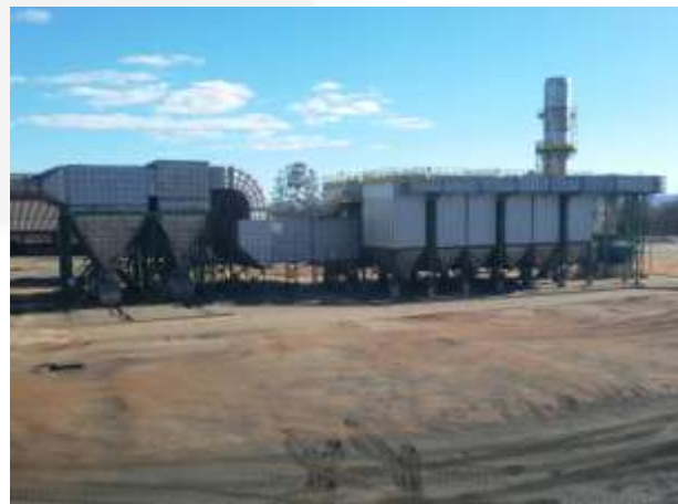
Foto 04. Sistema de Desp. do Forno S2
