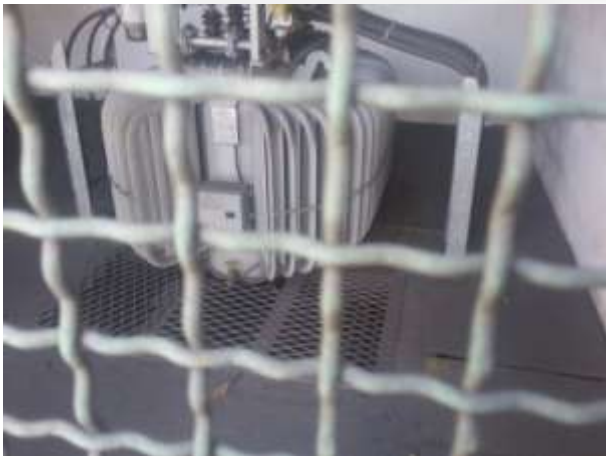
Foto 05. Transformador próx. Área Britagem
