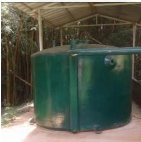
Foto 03. Estação de tratamento de efluentes.
