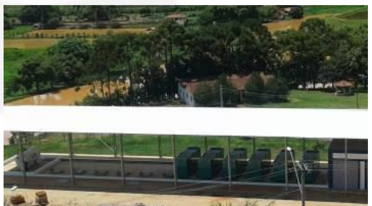
Foto 04. Área de armazenamento do diesel para abastecimento dos geradores.
