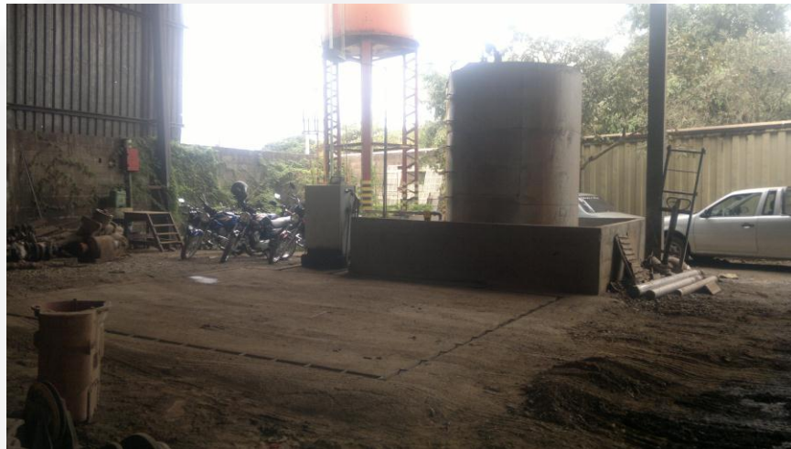
Foto 05: Vista do Posto de Combustível do Empreendimento com destaque para a bacia de contenção e pista impermeabilizada com canaletas ligadas a caixa SAO
