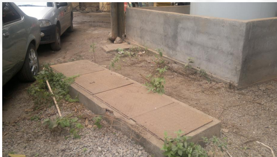
Foto 06: Vista da Caixa SAO que atende o posto de combustível
