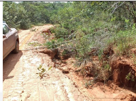
Foto 21: Foco erosivo em estradas e aceiros do empreendimento.
