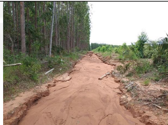
Foto 20: Foco erosivo em estradas e aceiros do empreendimento.
