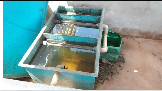
Foto 16: CSAO da area de apoio da carbonização.
