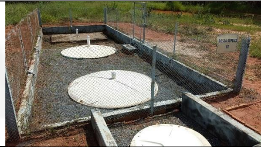
Foto 17: Sistema de tratamento de efluente sanitário da base de carbonização.
