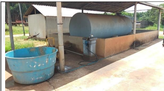
Foto 05: Tanque Aéreo de armazenamento de diesel.
