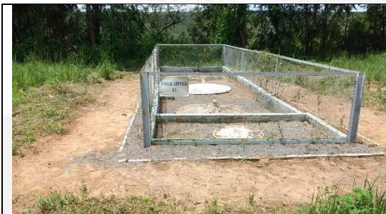
Foto 03: Sistema de tratamento de efluente sanitário - Sede
