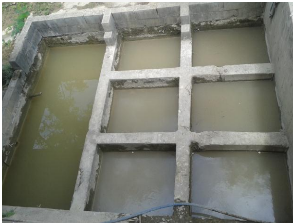
Foto 03. Caixa Separadora de Água e óleo
