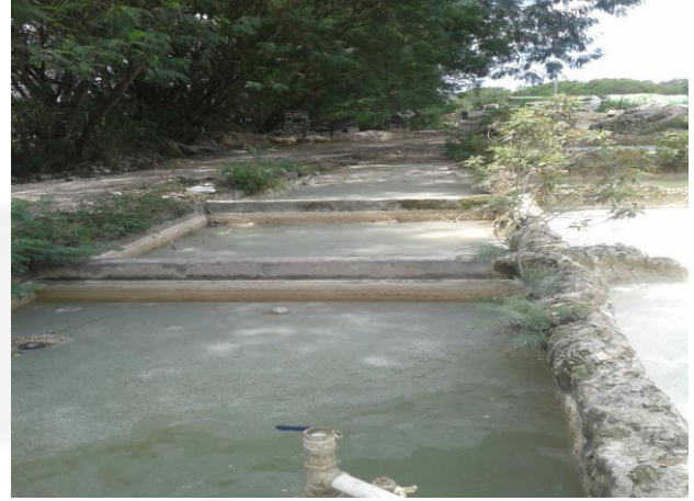
Foto 02. Sistema de decantação
