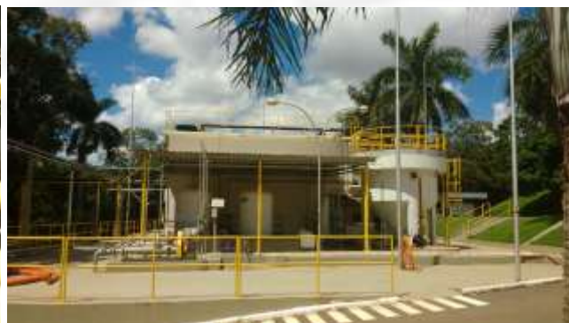
Foto 2 – Reator anaeróbio e flotodecantador
