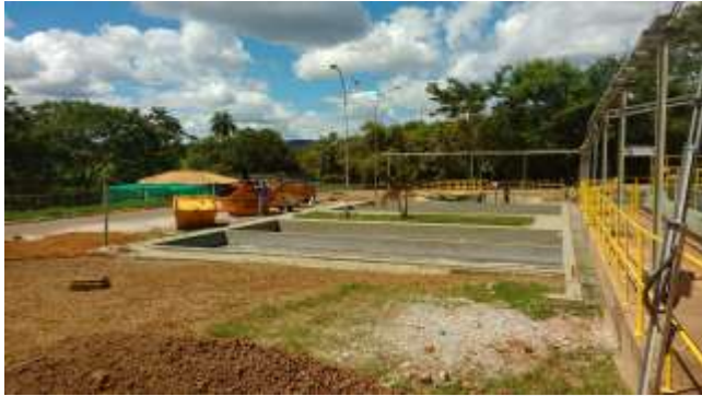
Foto 5 – Leitos de secagem
