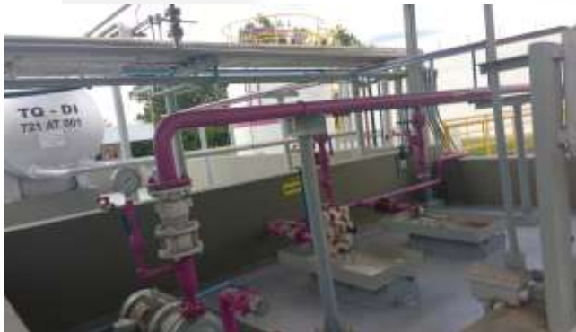
Foto 9 – Bacias de contenção dos tanques
