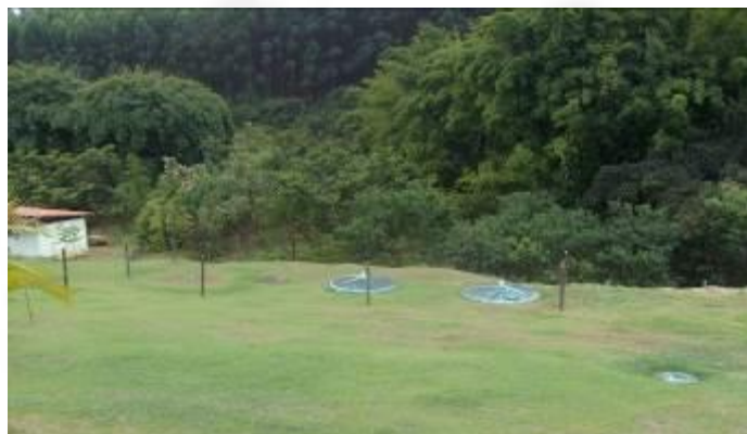
Foto 06: Sistema de tratamento de efluente sanitário.
