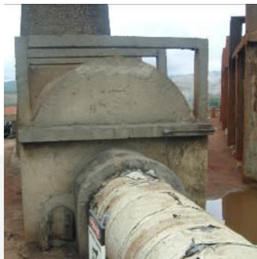
Foto 06: Vista parcial do duto ligado ao queimador de gases.
