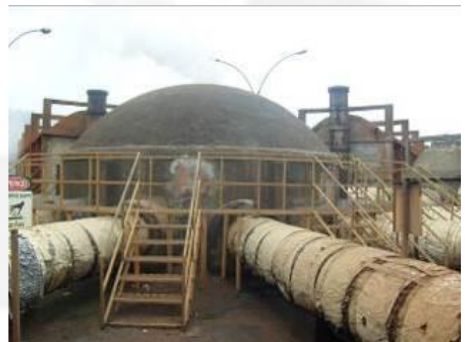
Foto 04. Dutos ligados ao misturador dos gases para homogeneizá-los antes da queima no queimador de gases.
