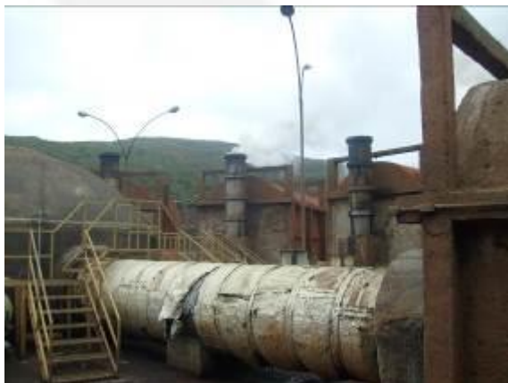
Foto 03. Vista parcial do queimador de gases – duto na saída do forno para coleta e condução dos gases da carbonização.
