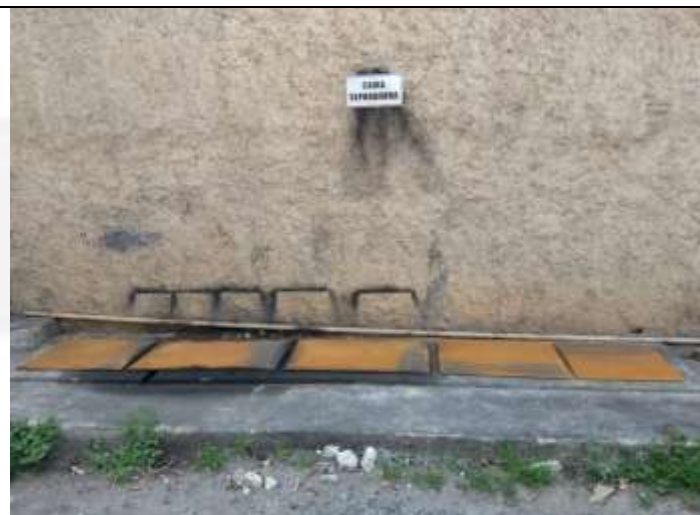
Foto 06 – Caixa separadora de água e óleo
