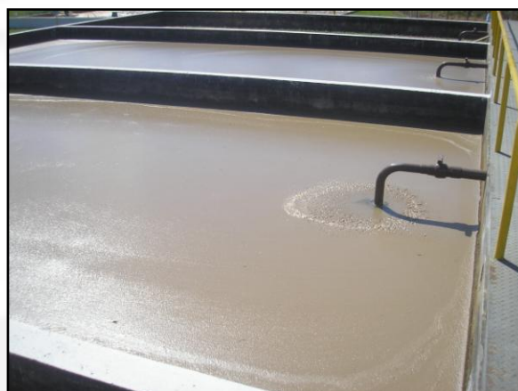
Foto 04. Leitos de Secagem.
