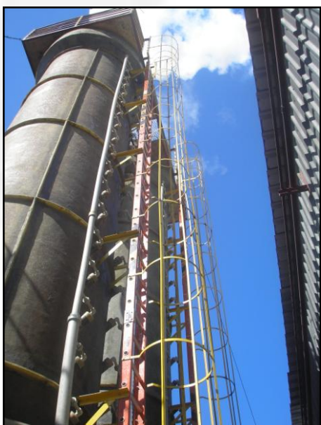
Foto 03. Lavadores de gases das Caldeiras a lenha e a óleo do empreendimento.
