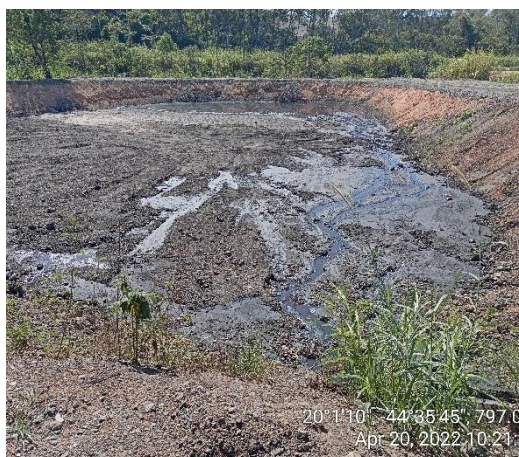
Foto 07. Local infiltração de águas pluviais
