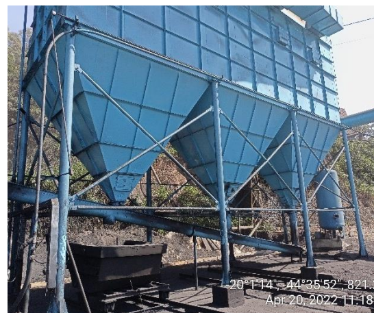
Foto 04. Filtro de mangas para despoejamento secundário.
