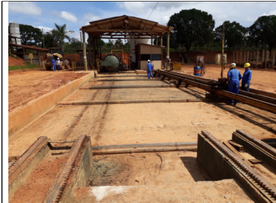
Figura 5. Autoclave e bacia de contenção.
