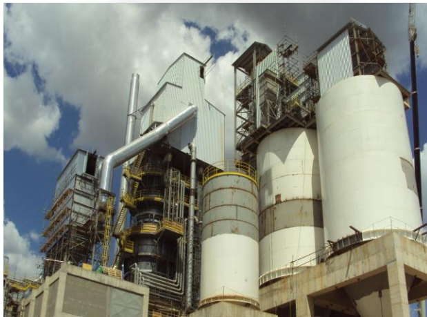
Foto 01. Forno e silos de cal
