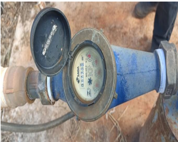
Foto 07 – Hidrômetro do poço tubular
