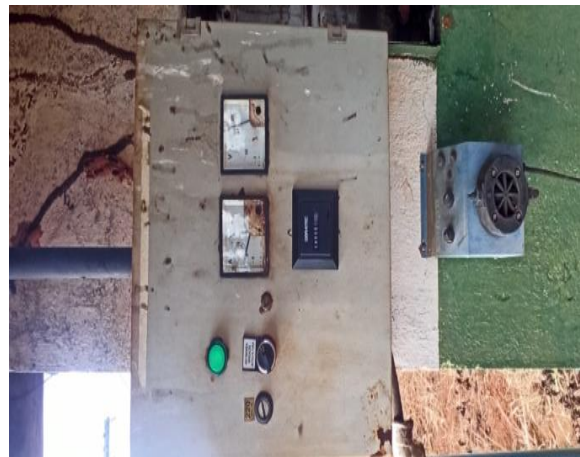
Foto 08 – Horímetro do poço tubular
