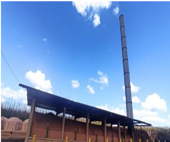
Foto 03 – Forno queimador de gases.
