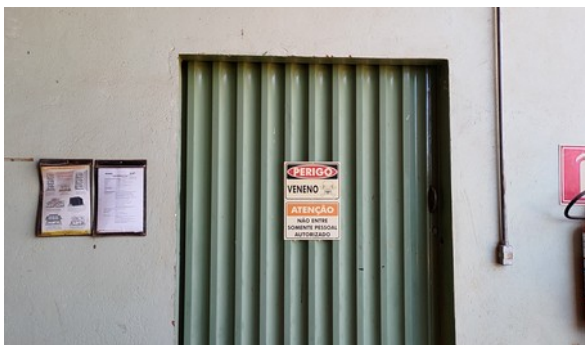
Imagem 40: Baia de resíduos sólidos
