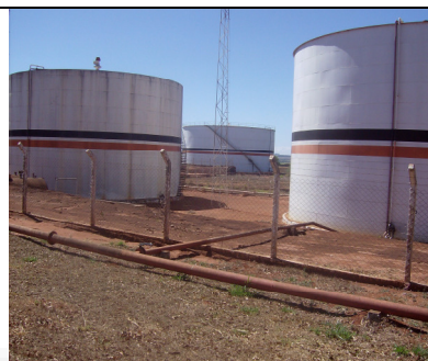
Figura 4- Tanques de armazenamento de álcool sem bacias de contenção
