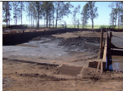
Figura 2- Bacias de sedimentação de águas residuárias (lavador de gases) sem impermeabilização
