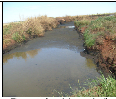
Figura 4- Canal de condução de vinhaça sem impermeabilização
