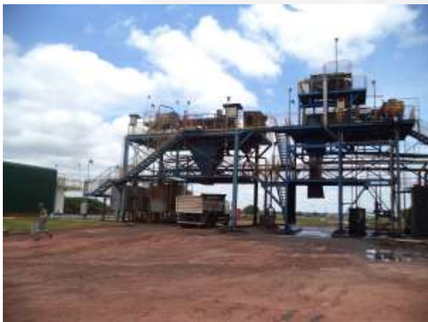
Foto 09. decantador de cinzas
