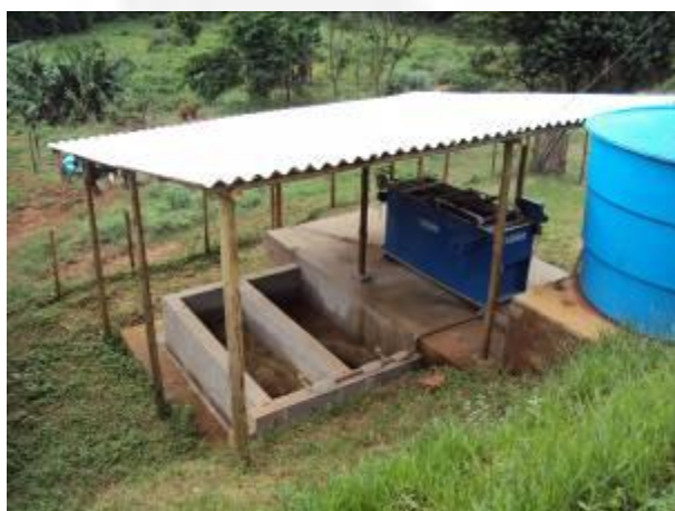
Foto 03. Sistema de tratamento de efluentes – ETE.
