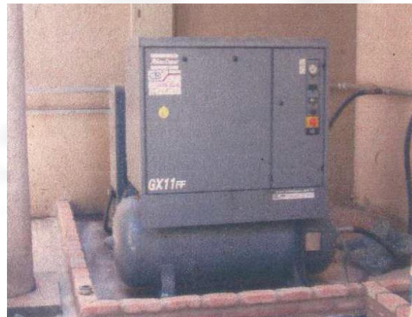
Foto 8: Área do Compressor de ar.
