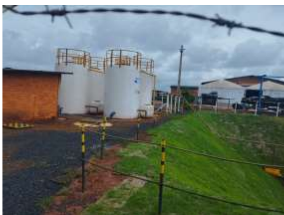
Foto 03. Estação de Tratamento de Efluentes sanitários.
