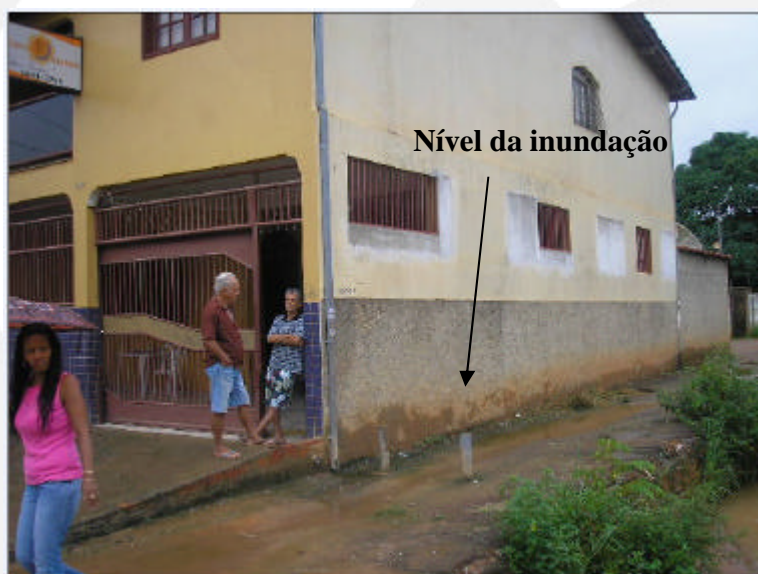
Foto 04: Vista do nível da inundação deixada na parede pelo afluente do Córrego Caladinho.
