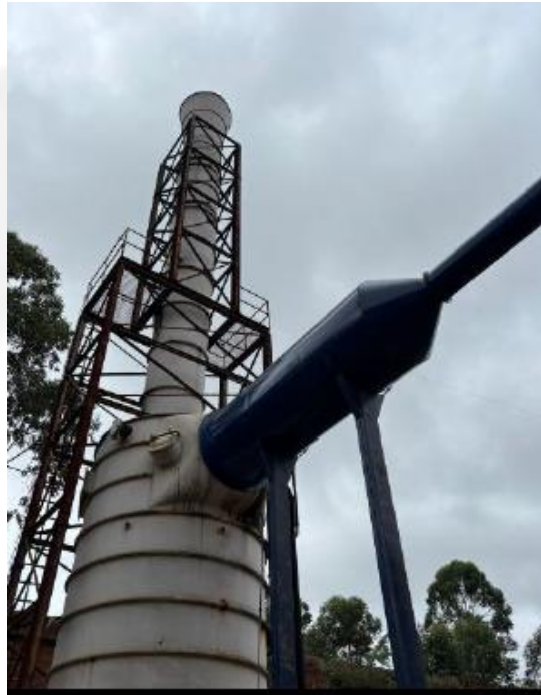
Figura 3 - Torre de lavagem de gases do empreendimento
