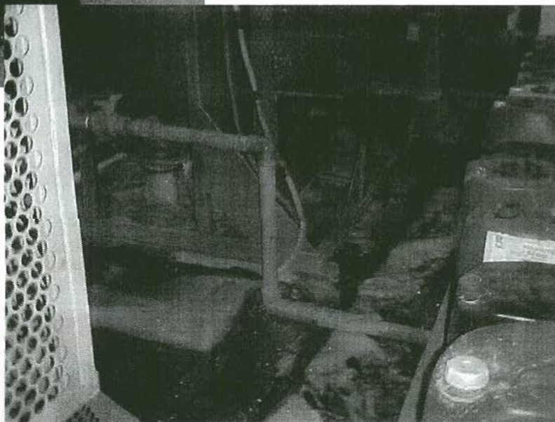
Vista da canaleta que direciona os efluentes das lavadoras para fora da unidade fabril.
