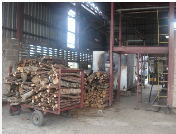
Foto 02. Galpão de geração de energia – caldeira.
