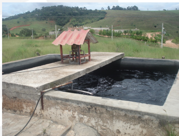
Foto 04. Sistema de tratamento de efluentes líquidos industriais.
