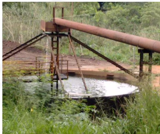
Foto 08. Tanques de água instalado em APP
