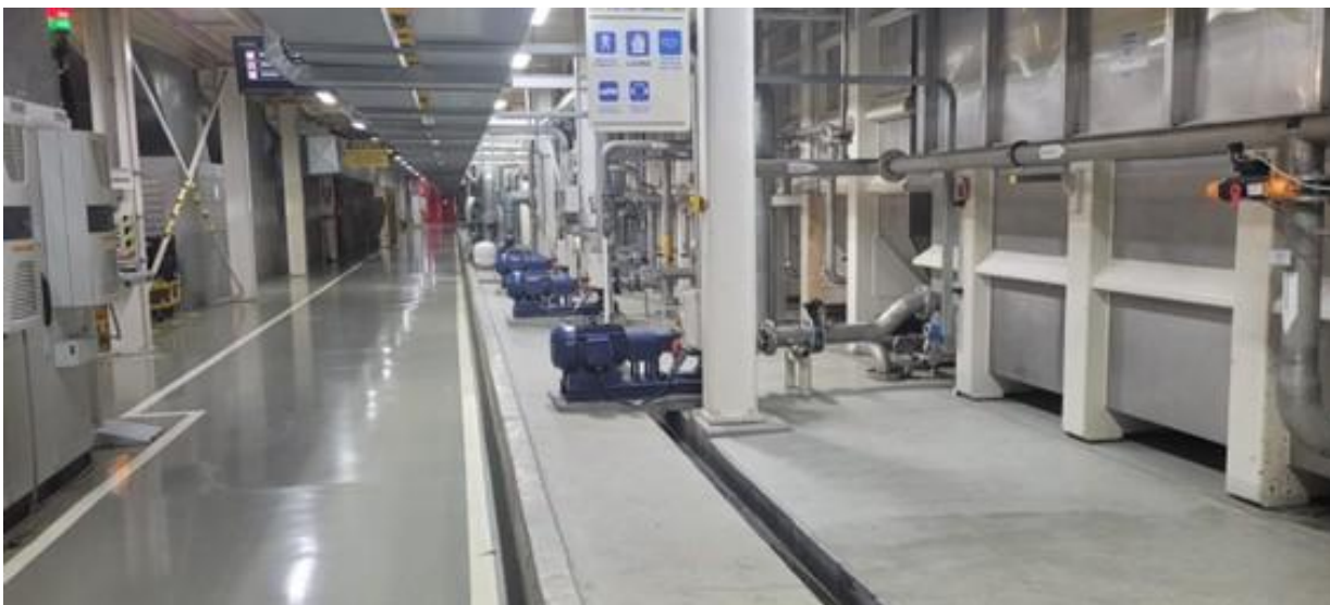
Visão geral da Estação de Tratamento dos Efluentes Industriais (ETE I) no setor de pintura, imagem obtida pela equipe técnica da URA/ZM em vistoria realizada em 30/03/2026
