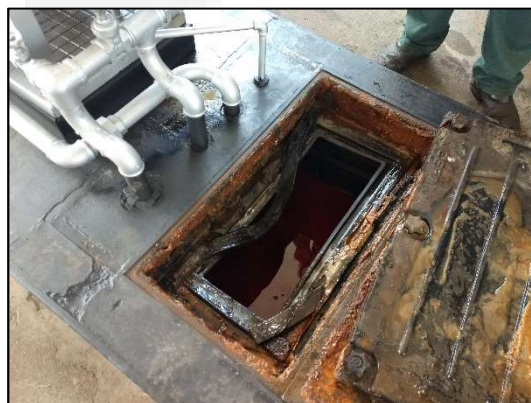
Foto 4: Sump do filtro de óleo diesel
