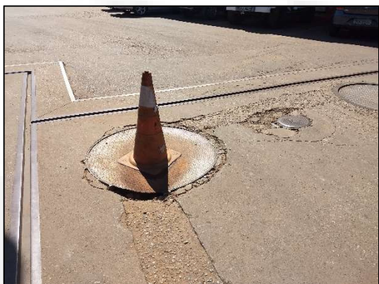
Foto 3: Tampa da boca de visita danificada
