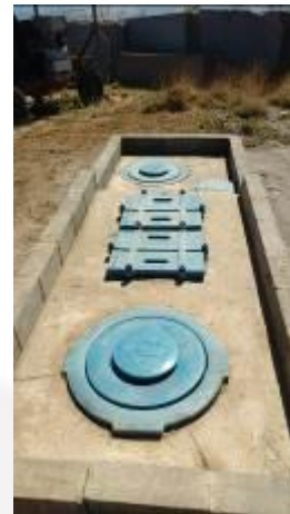
Foto 06. Caixa SAO do ponto de abastecimento.
