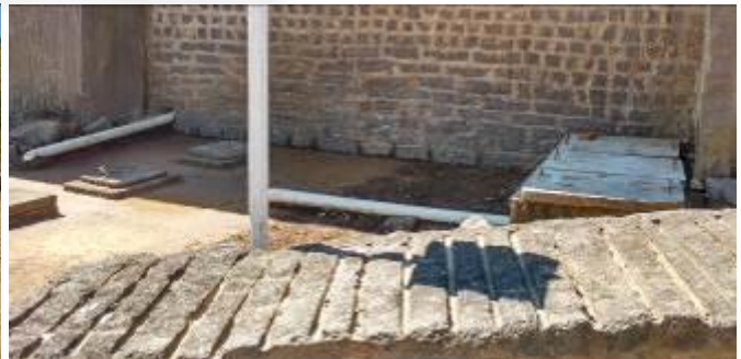
Foto 08. Caixa SAO da oficina mecânica.
