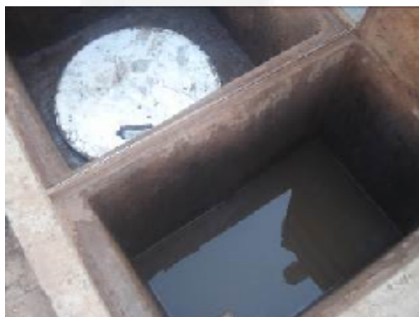
Foto 03. Caixa SAO da Pista de Abastecimento.
