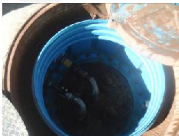
Foto 02. Sump da boca de visita de tanque.
