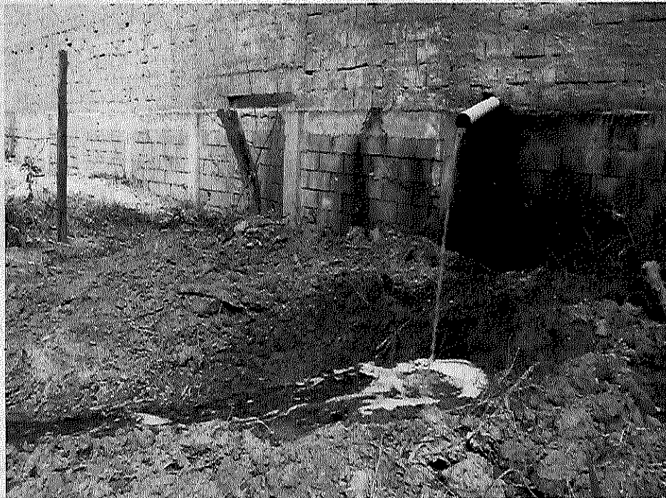
Foto 2: Lançamento de efluentes da caixa SAO diretamente no solo com geração espuma (registro feito em ocasião da vistoria realizada em 10/07/2017).
