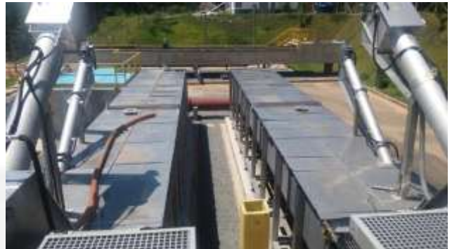
Foto 02: Vista superior dos desarenadores mecanizados do tratamento preliminar.
