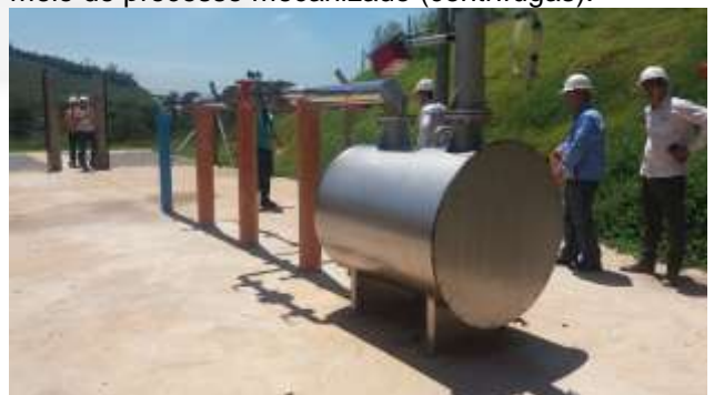
Foto 08: Queimador de biogás.
