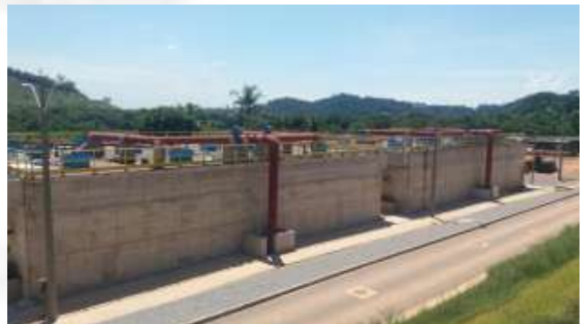
Foto 04: Reatores UASB para tratamento secundário do esgoto.
