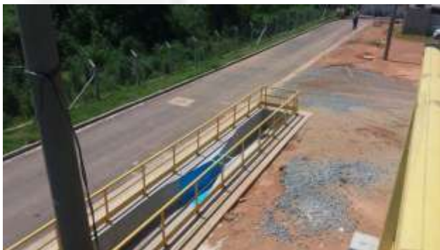
Foto 12: Medidor de vazão na saída da ETE (calha Parshall).
