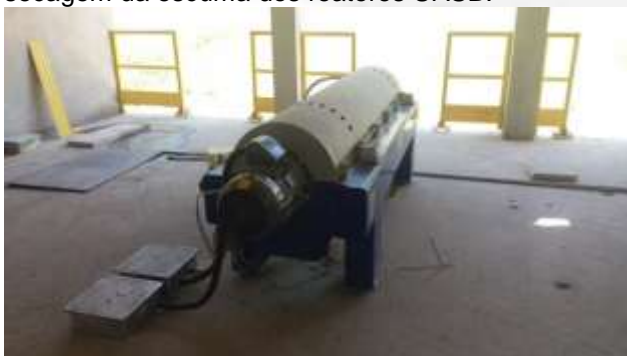
Foto 07: Centrífuga para desidratação do lodo.
