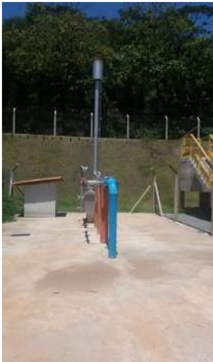
Foto 09: Queimador de biogás.
