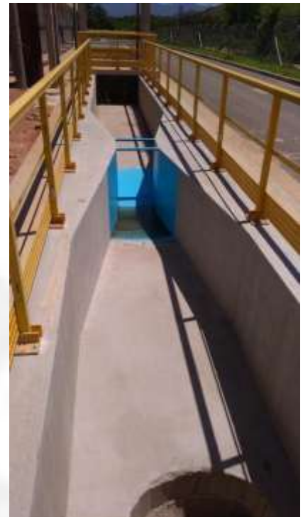
Foto 11: Medidor de vazão na saída da ETE (calha Parshall).
