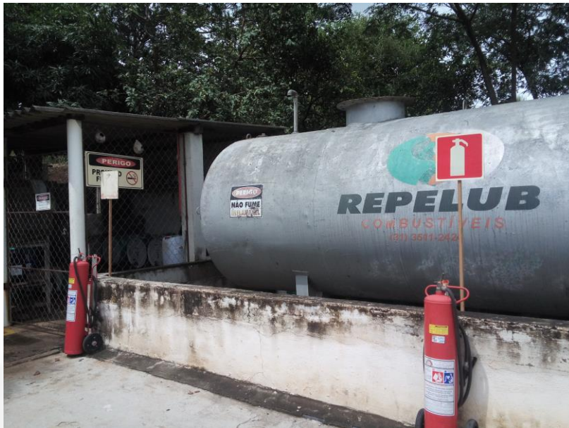
Imagem 4: Tanque de combustível 14.000 litros.
