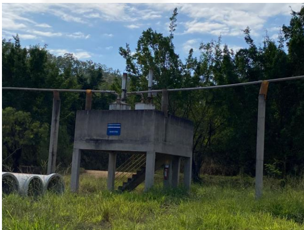
Foto 09: Queimador de gases.
