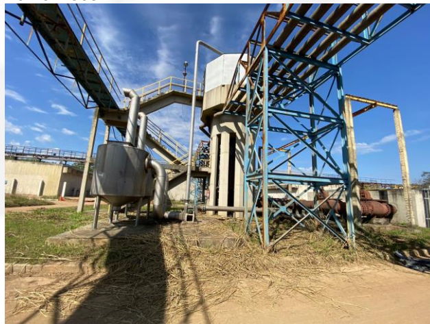
Foto 06: Torre de distribuição de efluente e filtro de carvão para tratamento de gás.
