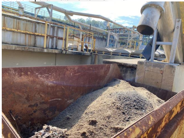
Foto 05: Caçamba para recolhimento dos resíduos retidos no tratamento preliminar – Gradeamento e Desarenador.
