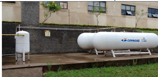
Foto 9: Central de armazenamento de gás GLP.
