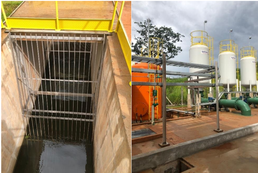
Figura 2-3 Gradeamento e tratamento de água captada
