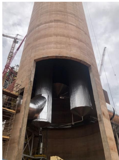
Figura 2-5 Saída unificada das chaminés
