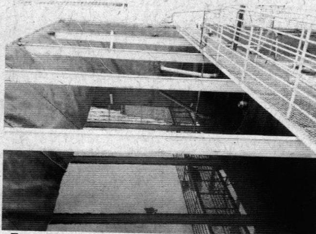
Foto 07. Vista parcial da ETE: último tanque
