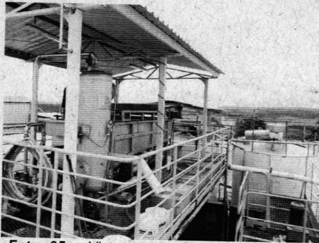
Foto 05. Vista parcial da ETE: flotador e centrífuga – decanter.
