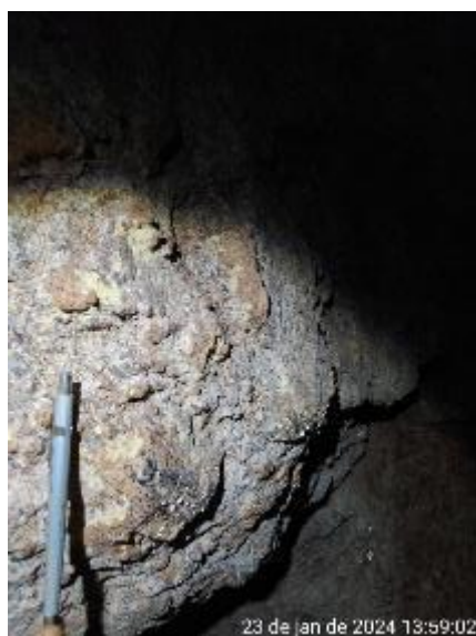
Foto 74 – Pontos de gotejamento e percolação.
