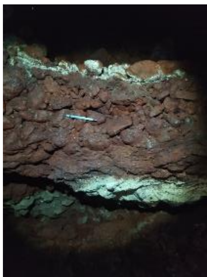
Foto 50 – Ponto de desagregação dos clastos na parede.
