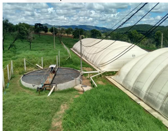
Foto 03. Biodigestores e tanque de homogeneização.
