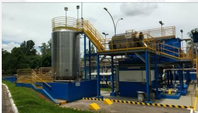
Foto 03. Estação de Tratamento de Efluentes - ETE
