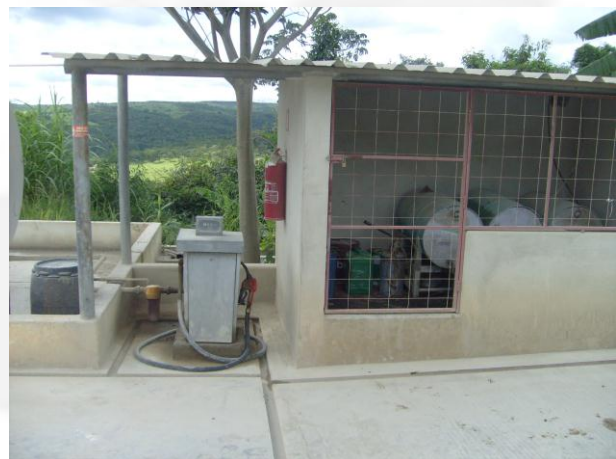
Foto 6. Bomba de combustível e local de armazenamento de tambores de óleo.
