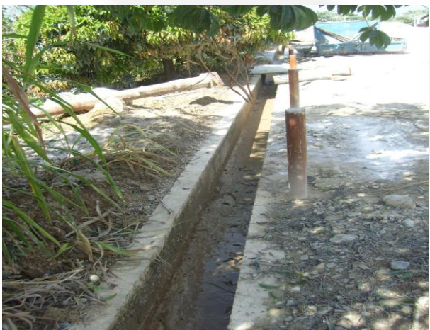
Foto 11. Canaleta de contenção de águas pluviais.
