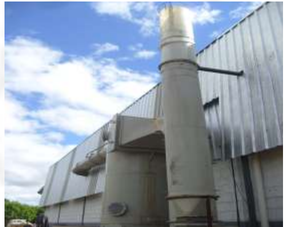
FOTO 02: LAVADOR DE GASES
