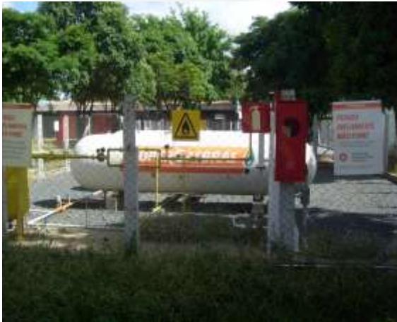
FOTO 01: TANQUE ARMAZENAMENTO GLP
