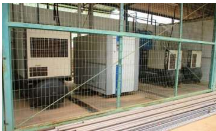
Figura 14 – Local de instalação dos compressores de ar, provido com estruturas de contenção.
