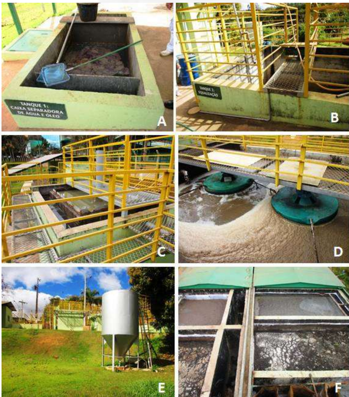
Figura 10 - Estação de Tratamento de Efluentes na unidade fabril da Indústria de Cosméticos Haskell Ltda: a) Caixa SAO; b) tanque de equalização; c) reator UASB; d) reator aeróbio; e) decantador; f) leito de secagem.
