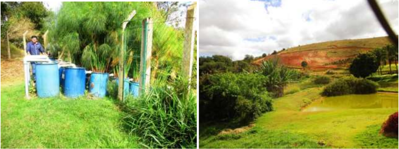
Figura 11 - Estação de Tratamento de Efluentes na unidade fabril da Indústria de Cosméticos Haskell Ltda: filtros lentos à esquerda e lagoa antes do lançamento no Córrego Cristal.
