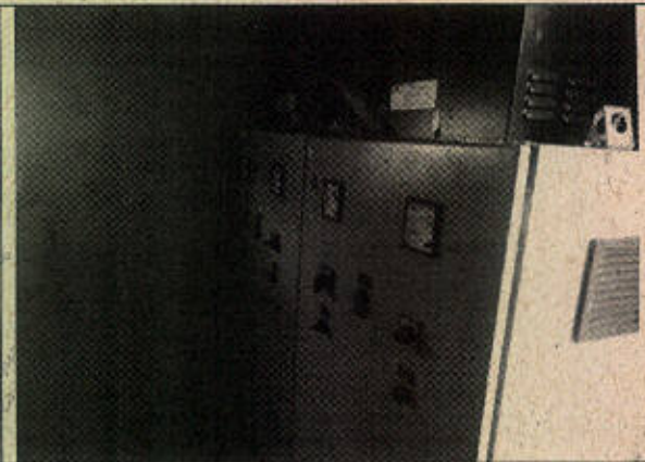
Foto 2. Sistema de captação sem horímetro.
