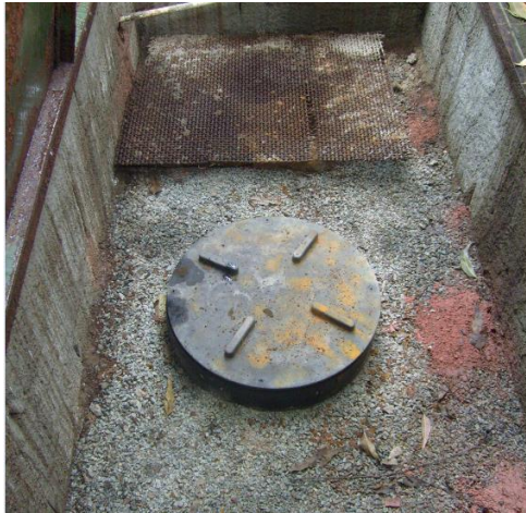
Foto 05. Biodigestor para tratamento dos efluentes sanitários.
