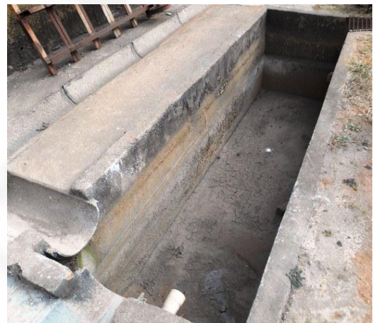
Foto 08. Sistema de drenagem pluvial
