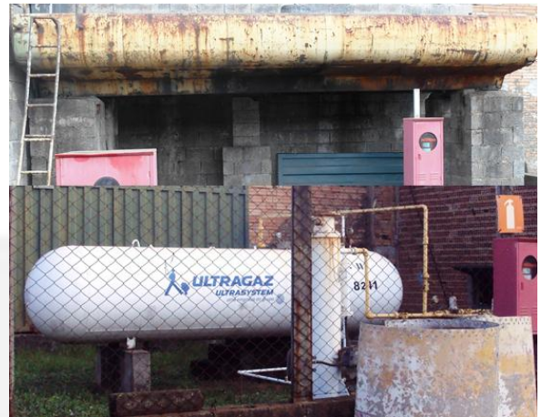
Foto 06. Tanques de óleo BPF e GLP
