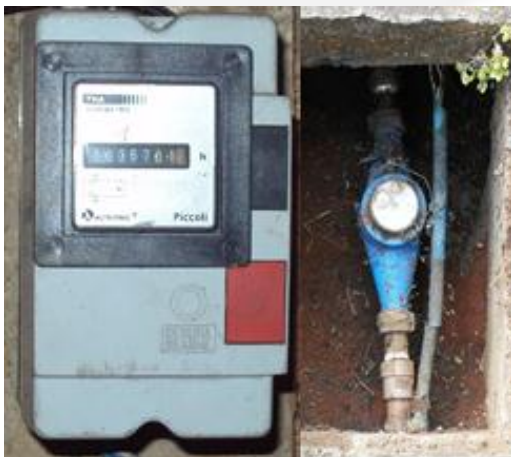
Foto 07. Horímetro e hidrômetro
