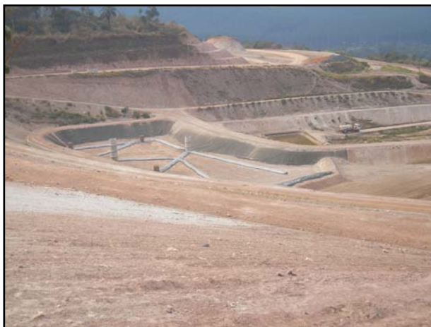
Foto 01: Drenos de fundo e Lagoa de Acumulação do Percolado.
