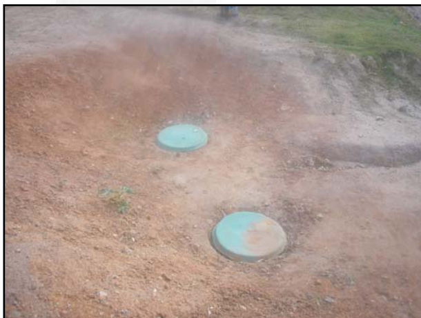
Foto 03: Sistema de Tratamento do Efluente Sanitário.
