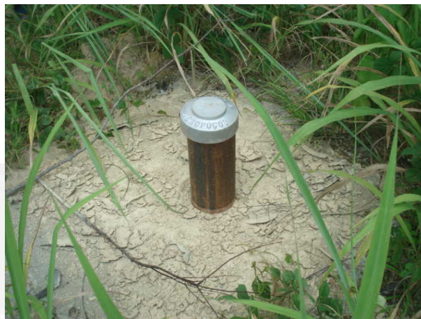
Foto 02. Poço tubular profundo.
