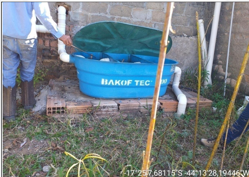
Figura 32: CSAO instalada no galpão oficina.
