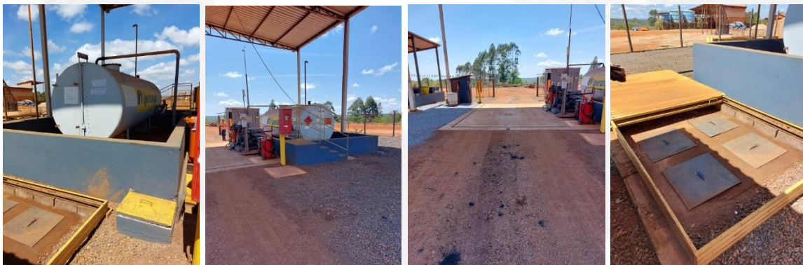
Fotos 8, 9, 10 e 11 – Ponto de abastecimento e caixas separadoras de água e óleo.
