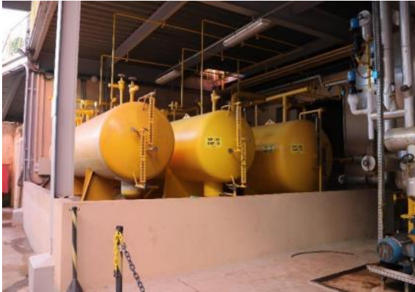
Foto 5: Tanques de amônia
