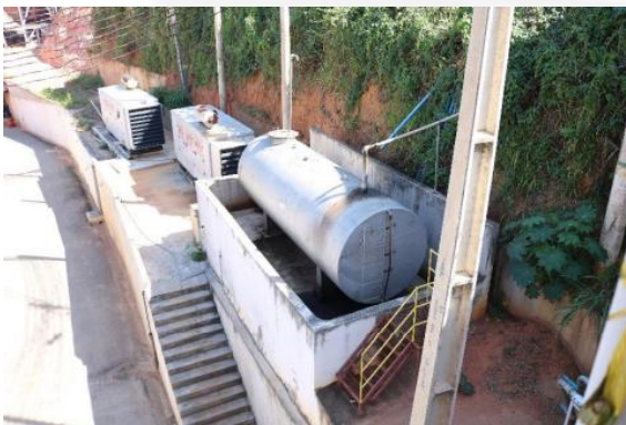
Foto 3: Geradores e tanque de combustível
