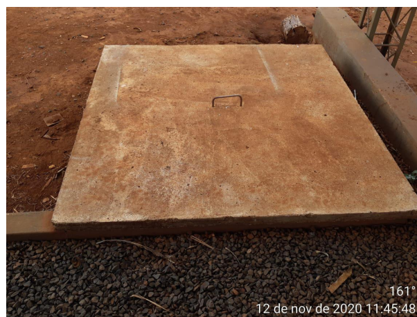
Figura 10. Caixa separadora de água e óleo (área de abastecimento)
