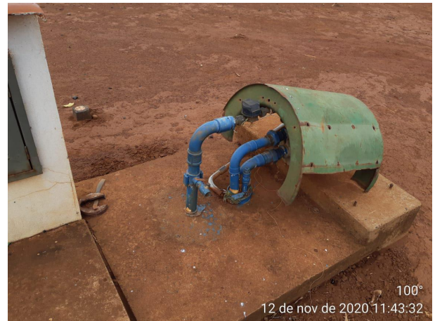
Figura 6. Captação de água subterrânea
